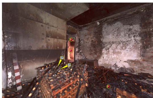
Obr. 7 Pohľad do jedálne na 1. NP po požiari. Fig. 7 Look on the dining room in 1st floor after fire.
