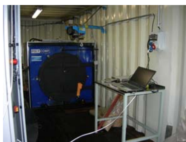
Obr. 1 Čelný pohľad na reaktor skúšobnej linky s riadiacim pultom Fig. 1 Front view of test lines reactor with control panel
